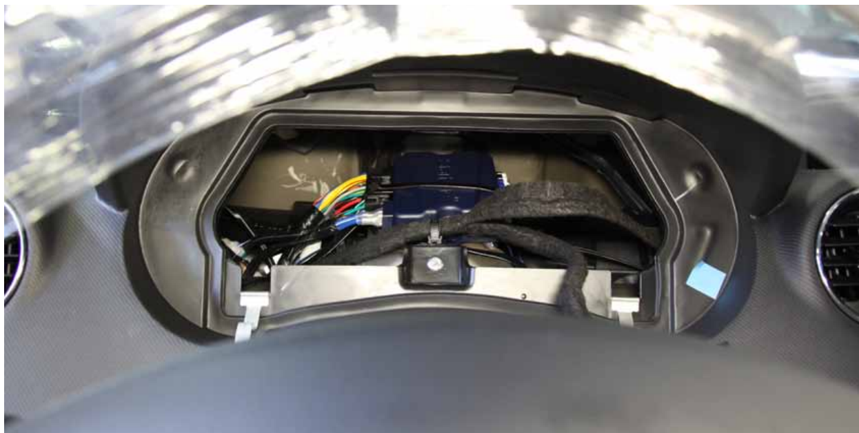
Фото 9. Блок сигнализации за щитком приборов
