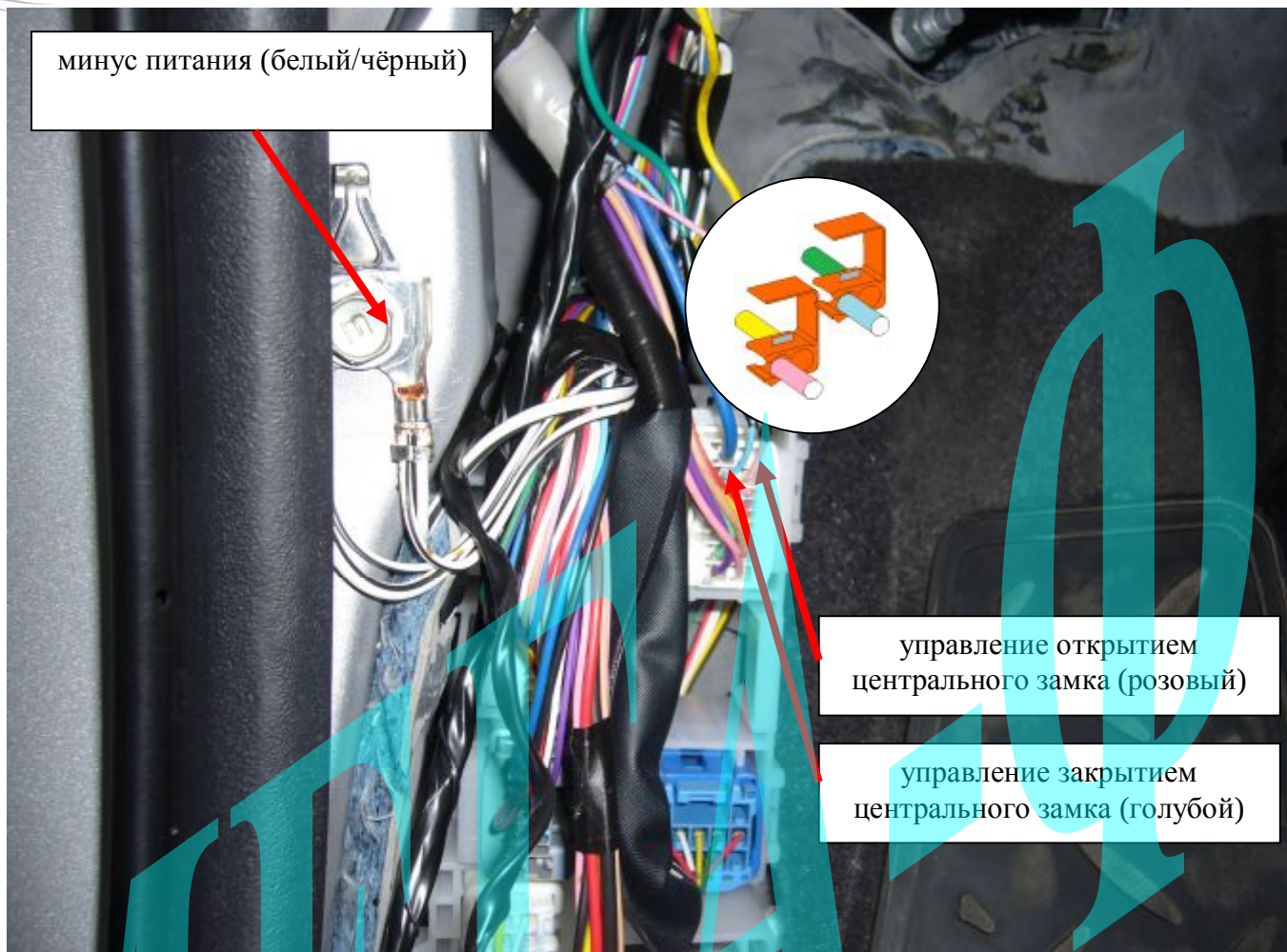
Рис. 1: Подключение управления центральным замком и минуса питания в левой кикпанеле.
